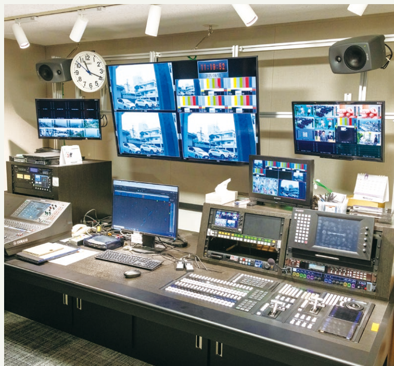
副調整室(サブ)の様子
